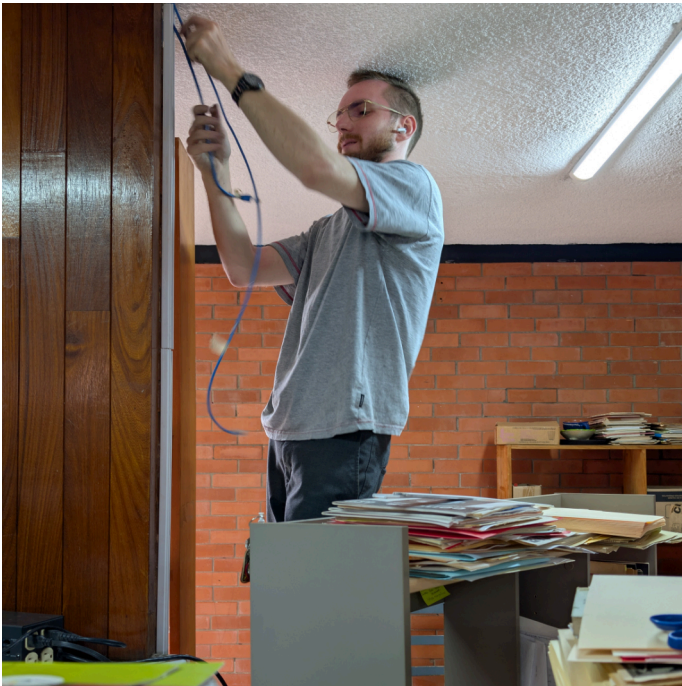
Erneuerung der Netzwerkinfrastruktur in der Bibliothek der CTdeM.
